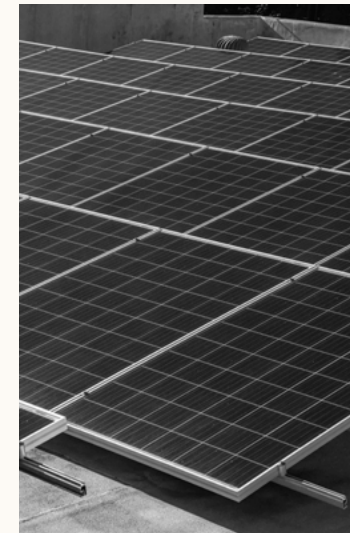
▲ Instalaciones de placas solares
