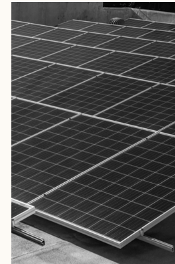
▲ Instalaciones de placas solares
